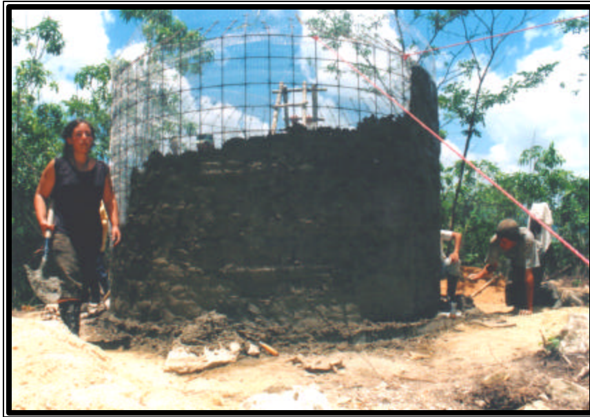
Embarrado del tanque
